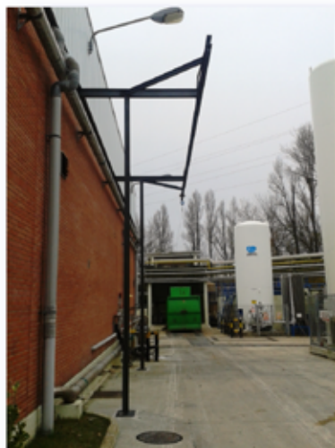
Estructura fijada en pared.
